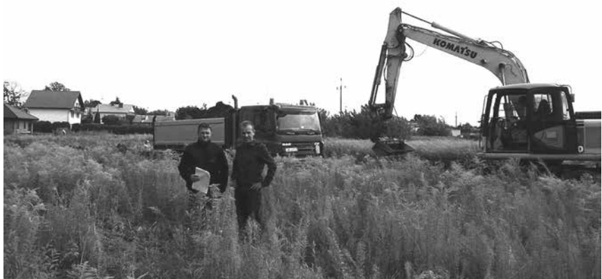
Wolica, ul. Oliwkowa. Z prawej Jacek Żukowski Radny Gminy Nadarzyn na placu budowy. Planowany termin zakończenia prac 27 września br.
