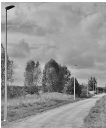
Fot. ul. Bukietowa w Walendowie - nowopowstałe oświetlenie.
